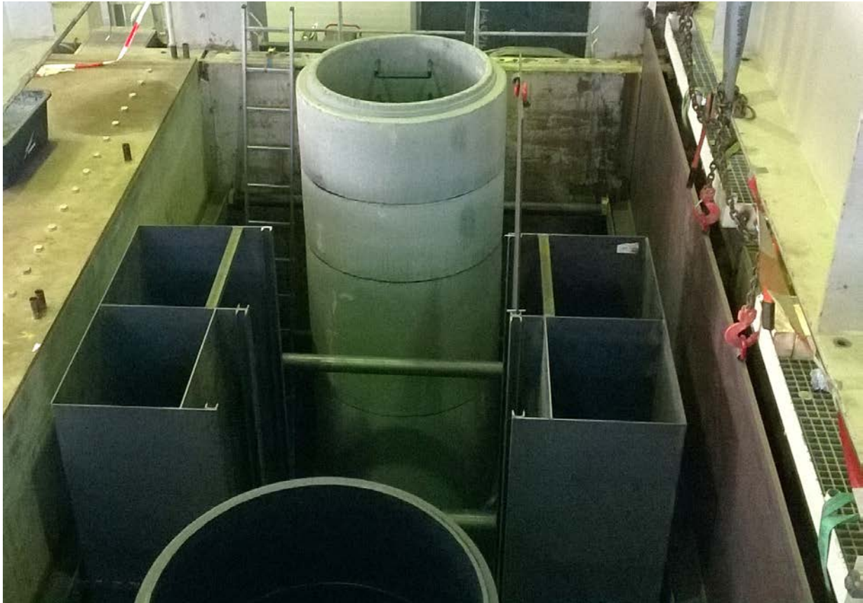
Bild 4 Einbauten in einer Versuchskammer vor dem Einbau des Flüssigbodens (ZFSV) mit Betonschicht (hinten), Kunststoffschicht (vorne) und Verbaukästen (seitlich)
