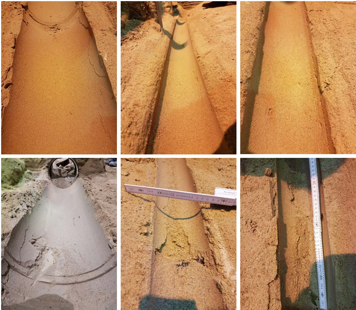
Bild 11 Bewertung des Kriteriums „Leitungsumschließung“. Exemplarisch Beispiele für keine Auffälligkeiten (Hauptleitung (oben links), Längsleitung (oben mitte) und Querleitung (oben rechts) sowie Auffälligkeiten bei der TerraFlow-Hauptleitung (unten links) und bei der RSS-Querleitung (unten mitte) und bei der RSS-Längsleitung (unten rechts)
